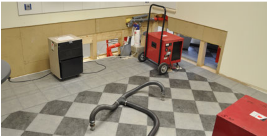
Nach der Durchfeuchtung wurden zunächst Trocknungsmaßnahmen im Überdruckverfahren eingeleitet. Wegen des Schimmelfalls empfahl der Gutachter, auf das Unterdruckverfahren umzustellen.
