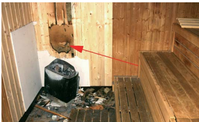
Saunabrund in einem Fitness-Studio: Hinter der mit Gipskarton verkleideten Wand kam es zu einem Wärmestau.
