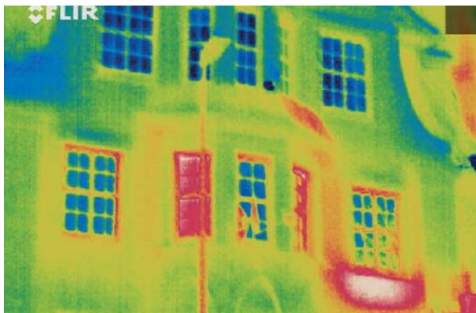
Infrarotaufnahme der Fassade: Die Wärme des Heizkörpers unter dem rechten Fenster geht über die unzureichend isolierte Außenwand verloren.
