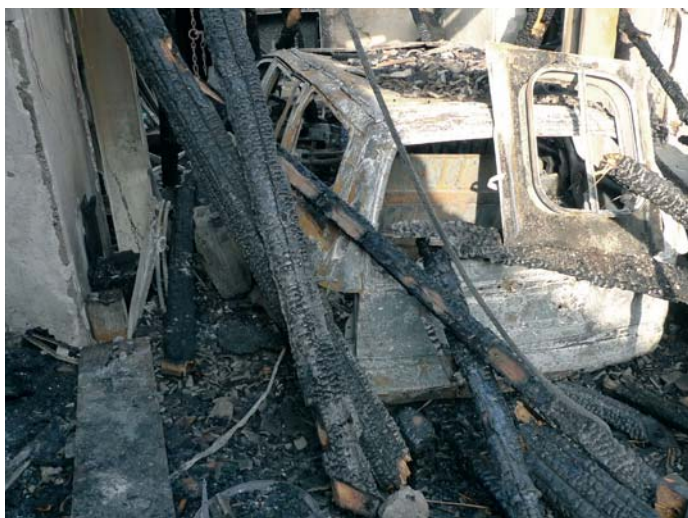
Der Pkw in der Scheune brannte nach den Schweißarbeiten vollständig aus, und auch das Gebäude wurde zerstört.
