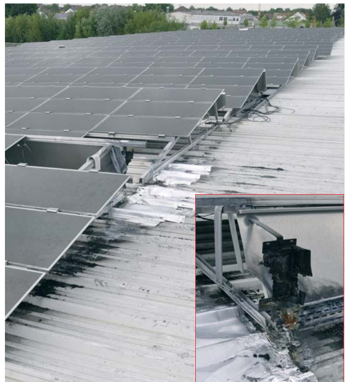
Der betroffene Teil der Photovoltaikanlage: Der Vorsammler im Schadenszentrum (kleines Bild) wurde vollkommen zerstört. Fotos: IFS
