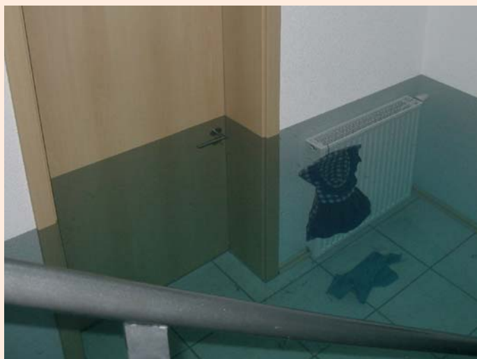
Der Keller steht wegen der gebrochenen Zählerhalterung unter Wasser.
