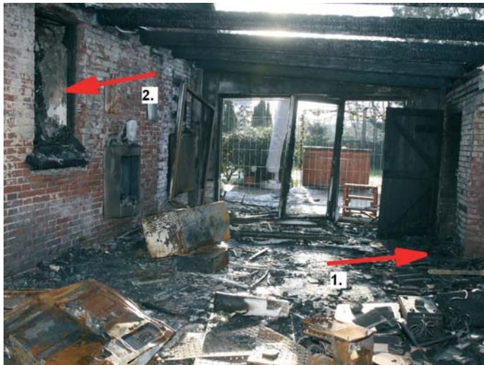
Der ausgebrannte Partyraum zwischen der Garage (1) und der Küche (2)
