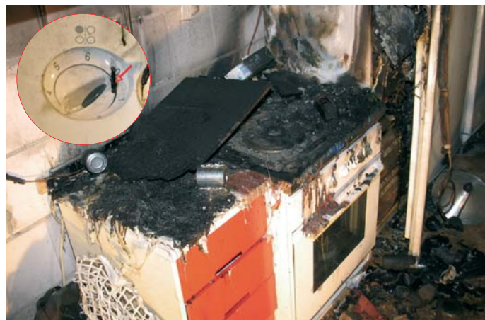
Feuer durch eine eingeschaltete Herdplatte: Die Ablaufspuren am Drehregler (kl. Bild) verraten die Schaltposition zum Schadenzeitpunkt.
