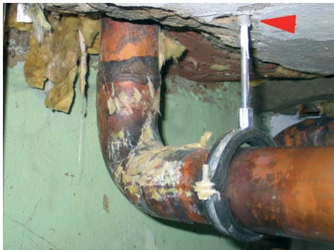
Kurz hinter dem Durchbruch in das zweite Untergeschoss liegt die erste Befestigung. Hier ist die Halterung samt Dübel (siehe Pfeil) aus der Decke gerutscht.
