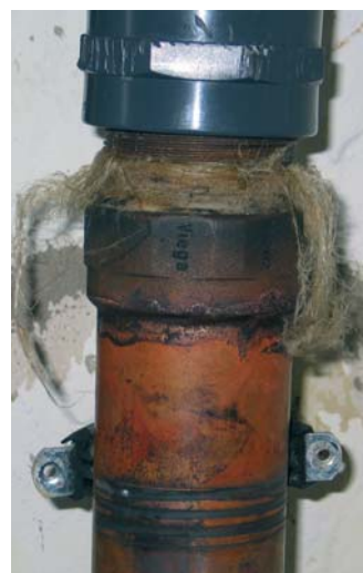
Diese Verschraubung im ersten Kellergeschoss hatte sich gelöst.
