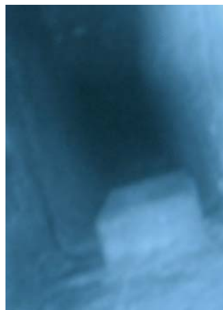
Die Schachtkamera zeigt: In den dritten Kaminzug ragt ein Balken.
