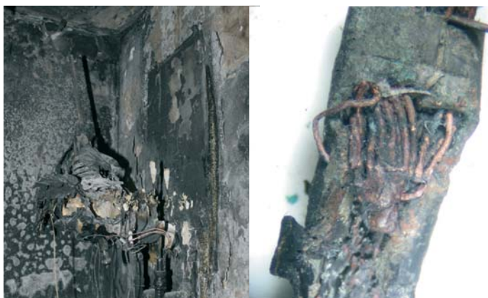
Die Reste des Warmwasserbereiters (links) und der Stecker in Nahaufnahme
