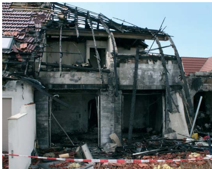
Die Rückseite des Hauses: Die Wohnzimmerfenster fehlen vollständig.
