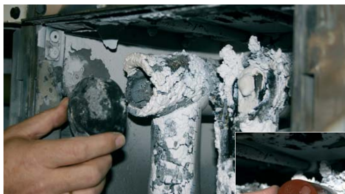
Die mittlere Abdeckkappe ist unbeschädigt. Rechts: Zur Verdeutlichung zeigt der Gutachter, wie der Monteur die Einsätze hätten montieren müssen.
