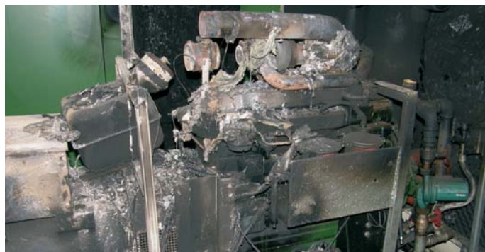
Der Dieselmotor des Blockheizkraftwerkes nach dem Feuer
