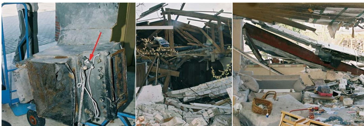
Eindrücke von einer Schadenstelle: Der Kessel (links) flog quer durch das Wohnzimmer (rechts) und riss die Außenwand des Wohnhauses ein.
