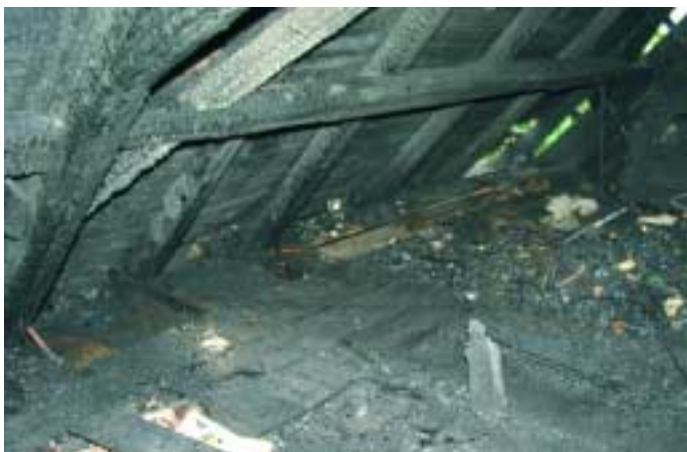
An dieser Stelle des Dachbodens stand vor dem Schaden die Weidentruhe mit Spielzeug.
