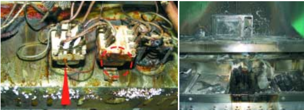
Thermostatschalter mit angeschlossener Kapillare (Pfeil); die Verbindung vom STB zum Thermofühler fehlt (Kreis). Rechts: Schadenstelle
